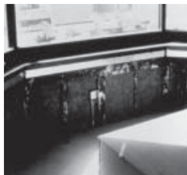
Foto 21 - Passagem de tubulações na cavidade entre os painéis de revestimento e o paramento interno (PCI, 1994).
